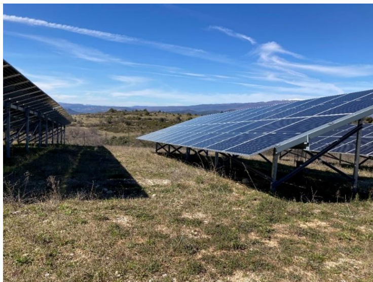
Structure photovoltaïque sur le site Les Mées (04) (Source : CVE)
